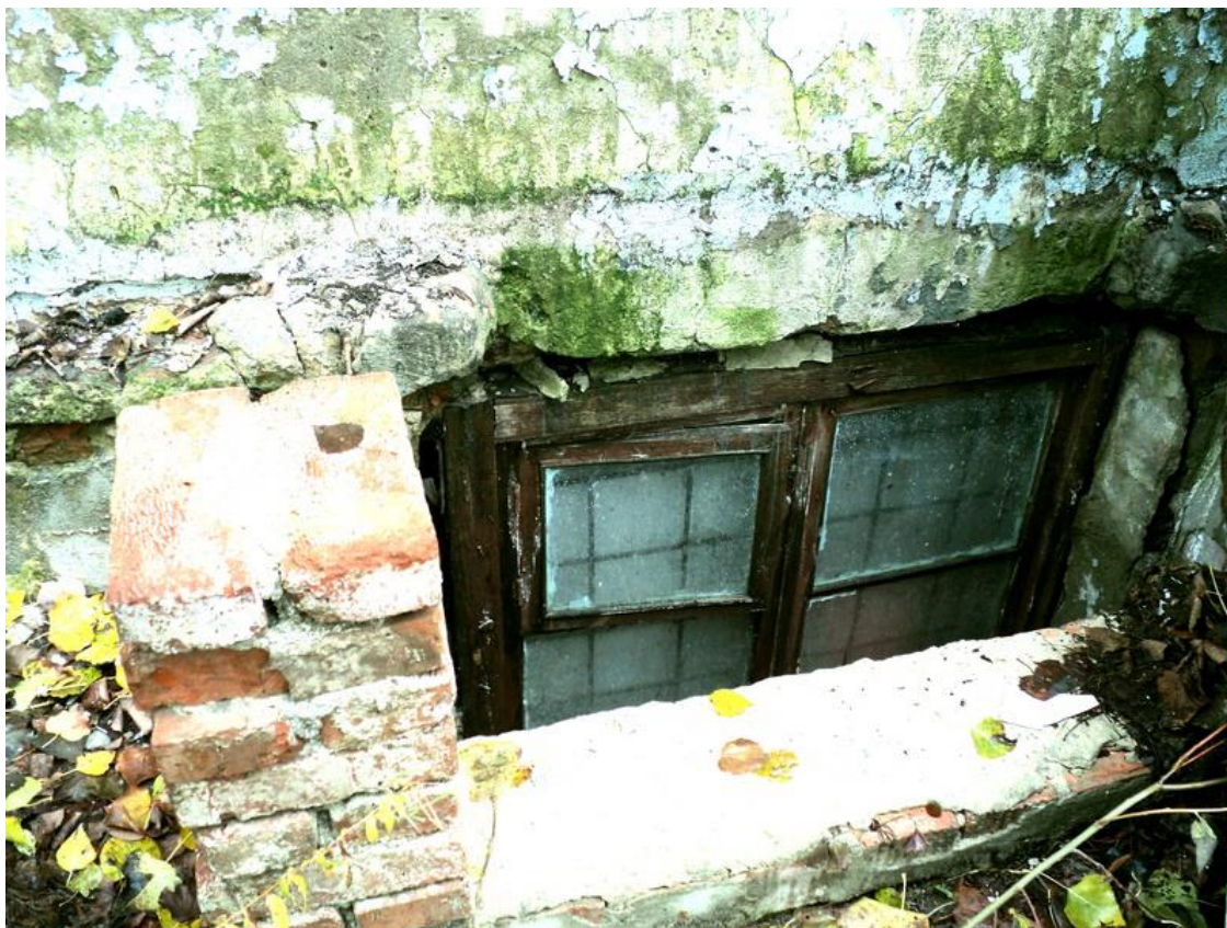
Окно цокольного этажа с разрушенным защитным козырьком, 25.10.2015
