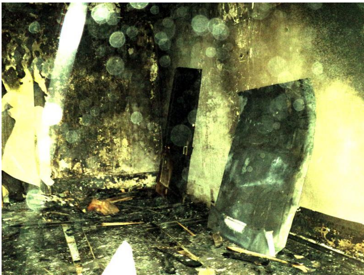
3-2-1 Очаг пожара на 1 этаже, левая половина здания казармы, 25.10.2015
