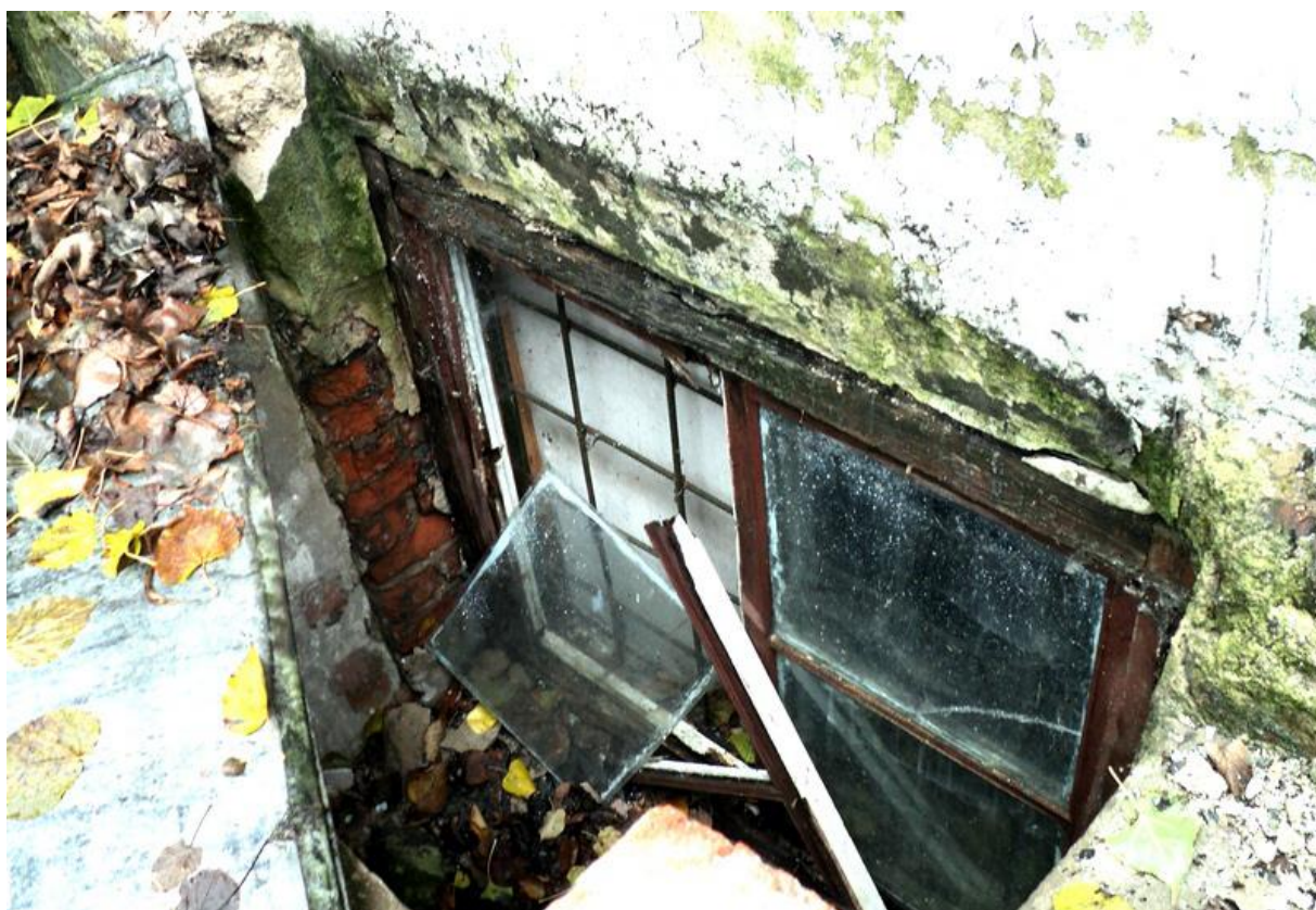
Окно цоколя с разрушенным козырьком, 25.10.2015
