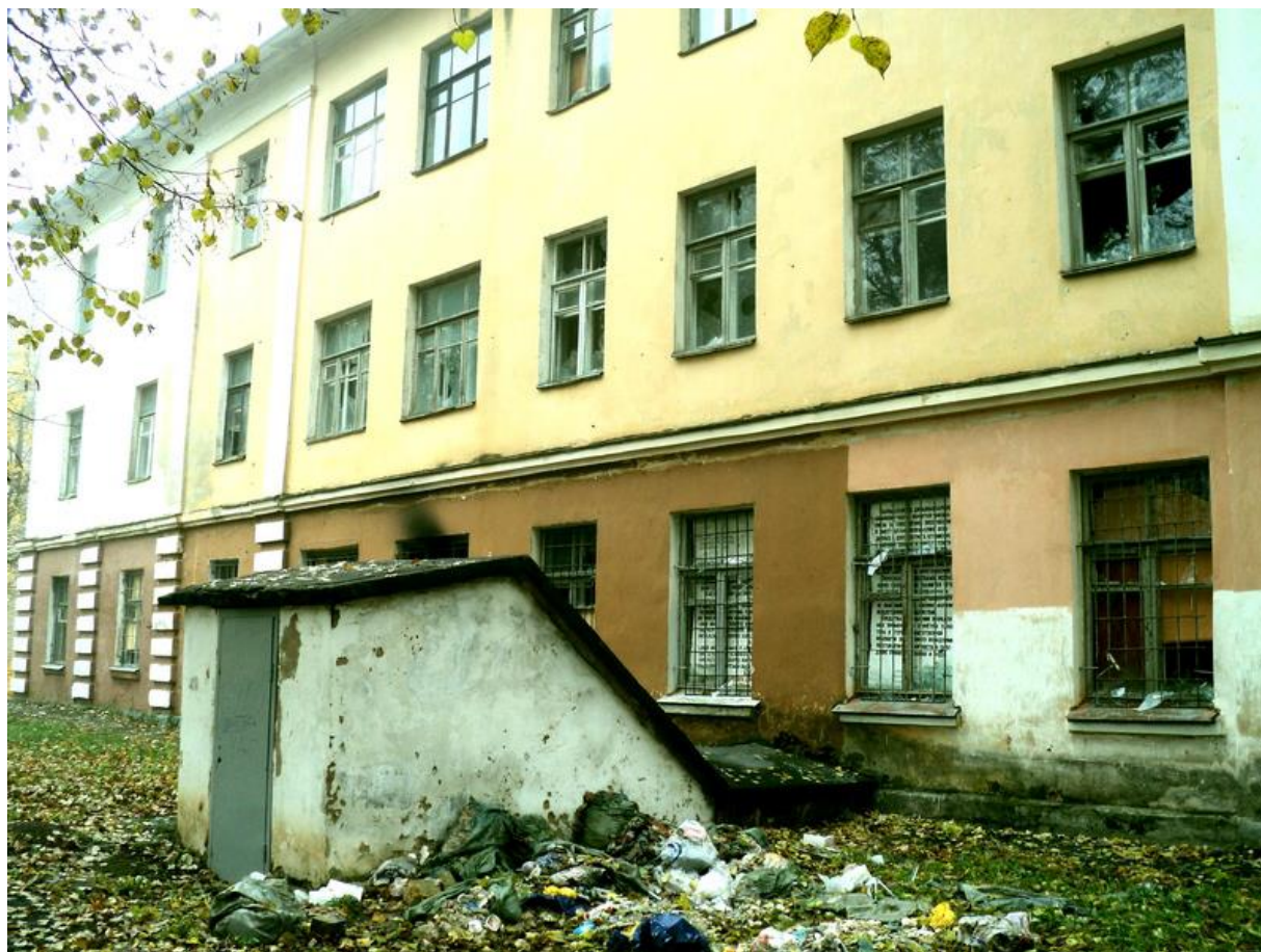
Отдельный вход (большой козырек) в цокольный этаж с тыльной стороны левой половины казармы после пожара, 25.10.2015
