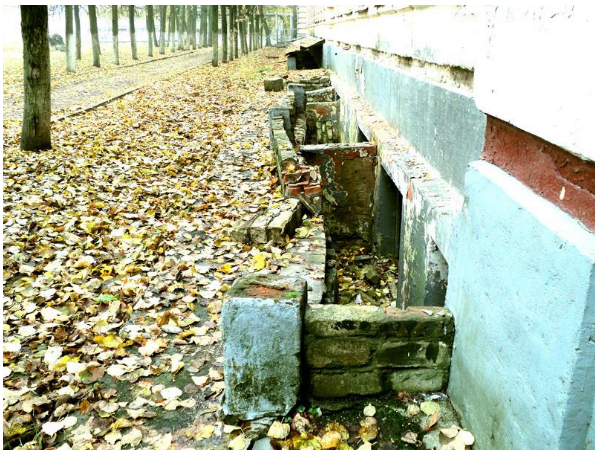
Разрушенные защитные козырьки над окнами цокольного этажа, 25.10.2015
