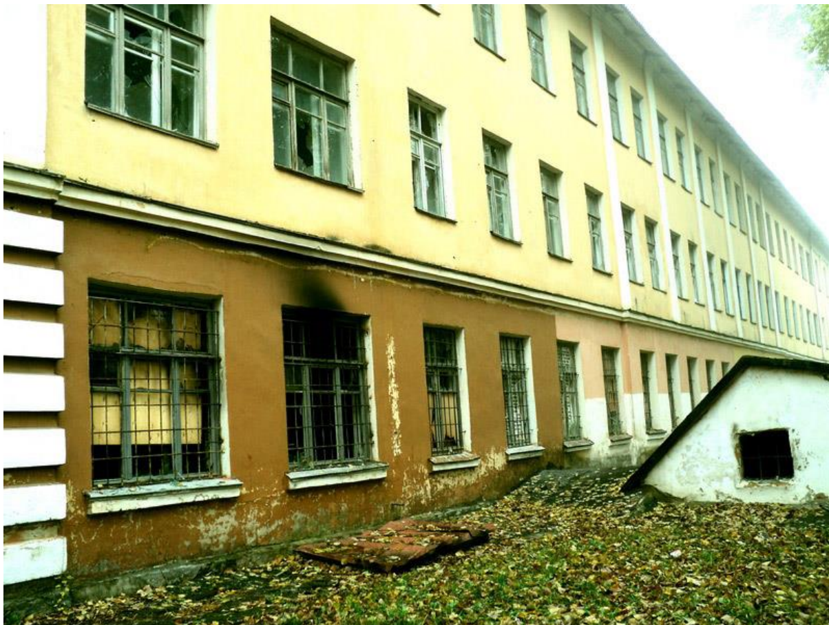
1-10-1. После пожара (1 э) в левом крыле здания казармы, 25.10.2015
