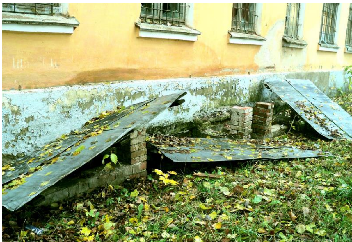
Разрушенные козырьки на тыльной стороне казармы, 25.10.2015
