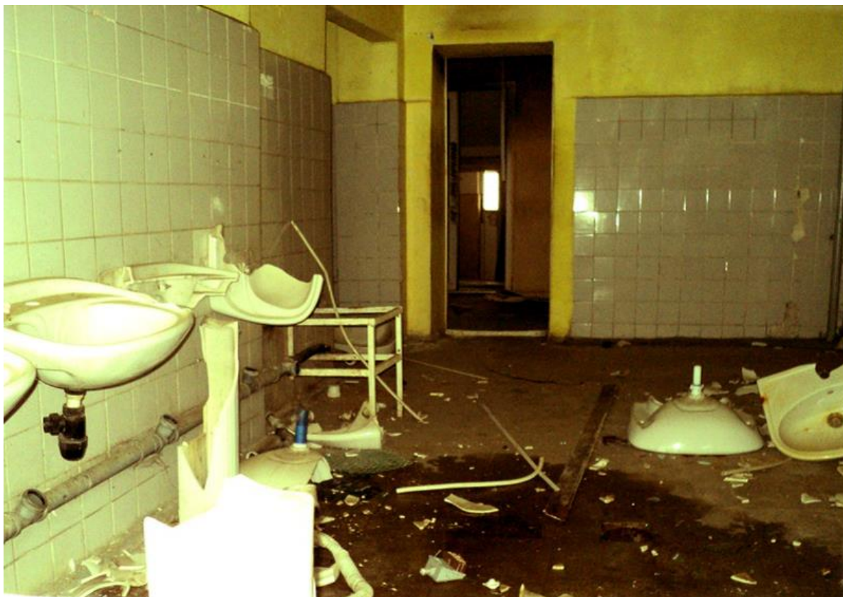
Разгромленное помещение для умывания в левой половине цокольного этажа, 25.10.2015
