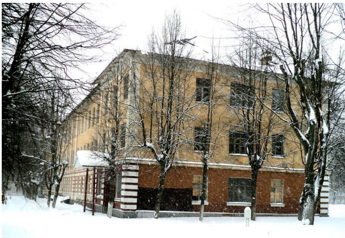
2-20-5. Левый торец здания казармы со сгоревшей крышей, 16.01.2016
